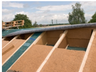
Blick in die Dämmebene der Dachkonstruktion. Vorgeämmte STEICO joist Stegträger mit STEICO flex Dämm-Matten.
